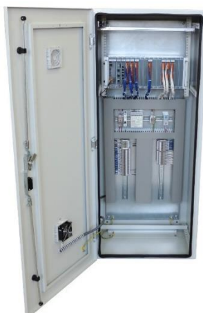
Příklad skříně pro menší rozvodnu
